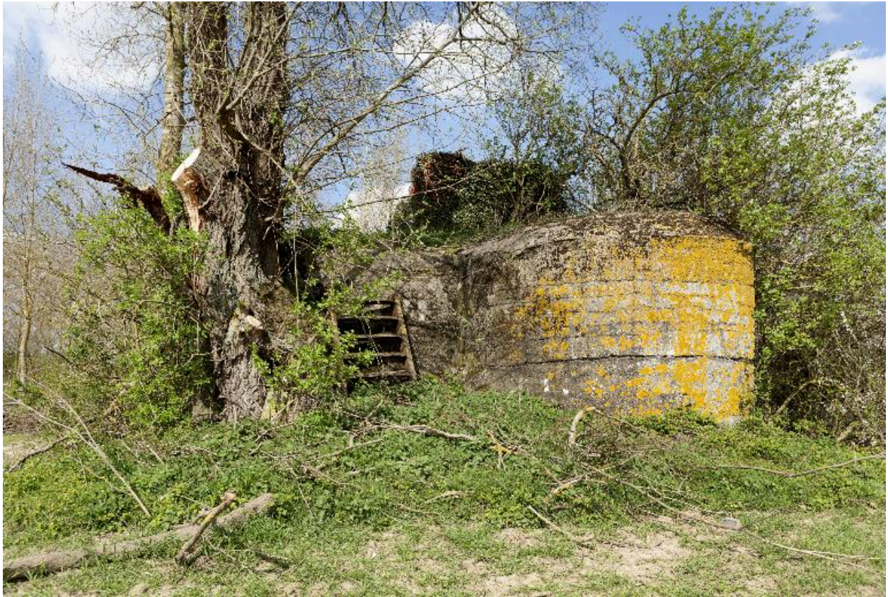
Edifice b vers le nord. L'escalier métallique et la structure sur le couverture ne sont pas d'origine.
