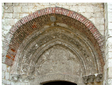
Détail du tympan et de la voûture du portail occidental. Phot. Frédéric Fournis IVR22_20148005201NUCA
