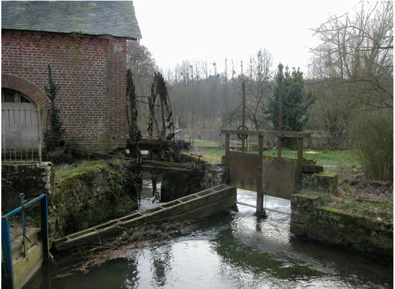
Le désersoir, vannage de décharge et la roue hydraulique.
