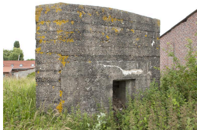
Guerite casematée (Bat. A). Détail de l'élévation sud Phot. Jean-Marc Ramette IVR31_20145904725NUCA
