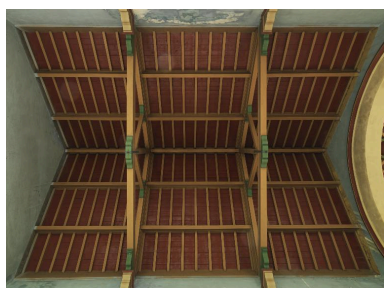
Vue de la charpente de l'une des nefs des malades. Phot. Thierry Lefébure IVR22_20128000048NUC4A
