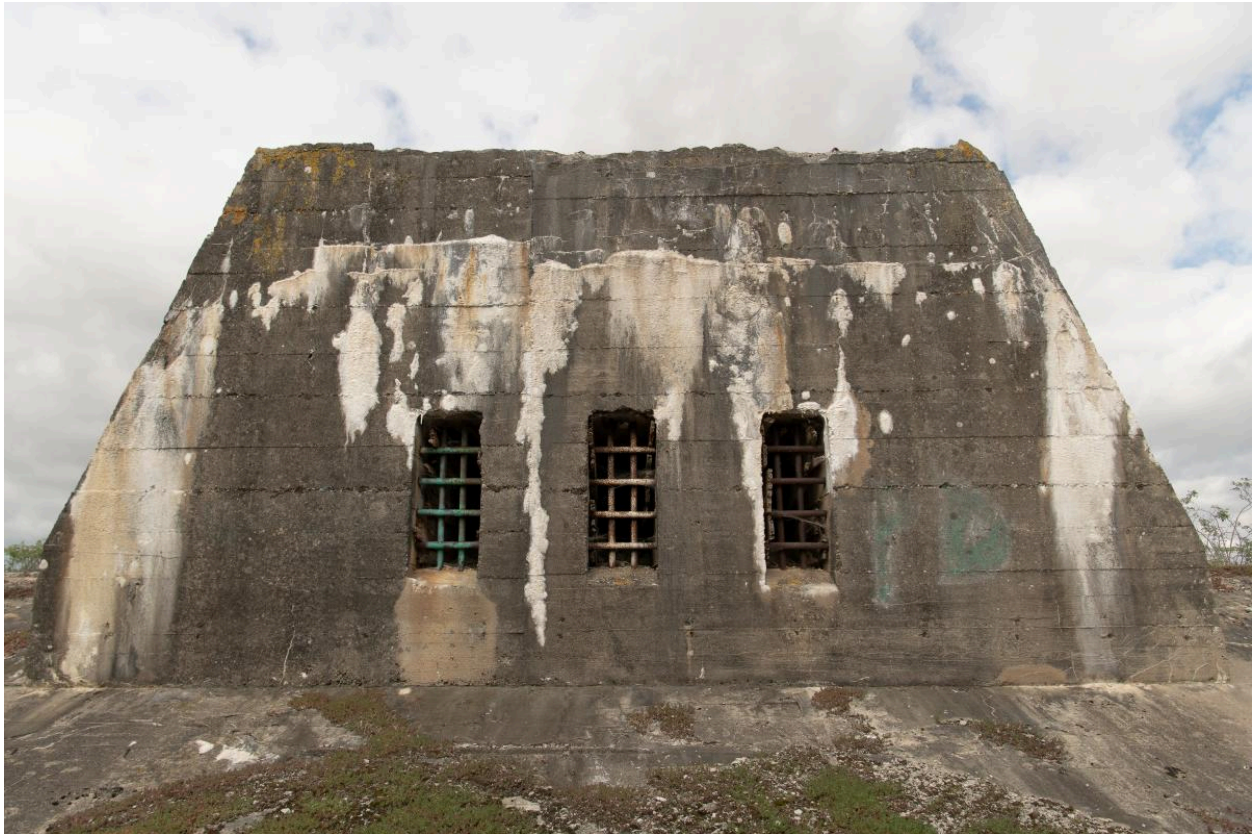
Un des trois blocs de ventilation, vue vers le nord-ouest.
