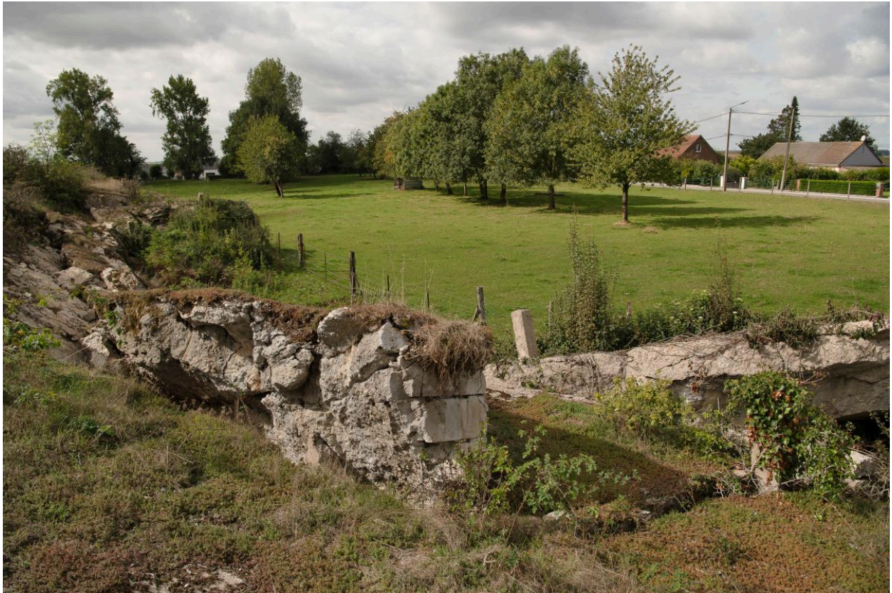
Partie effondrée de l'élévation nord-ouest, vue du sol.
