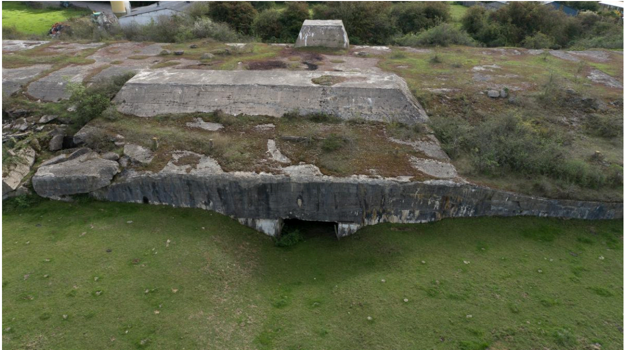
Vue aérienne de l'élévation nord-ouest. Détail de la sortie de la rampe de catapultage.
