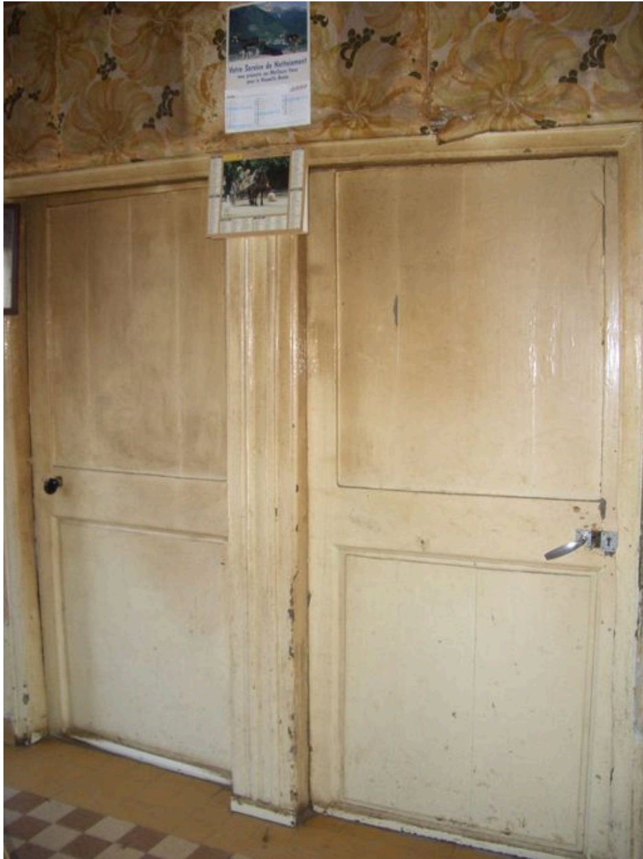
Autre exemple de la disposition des deux portes menant de la salle commune aux deux "cabinets" ou chambres.
