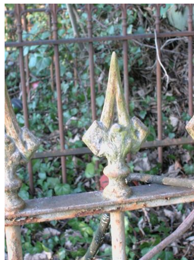
Vue de la grille. Détail des fers de lance. Phot. Laurent Nicolas IVR22_20058002172NUCA
