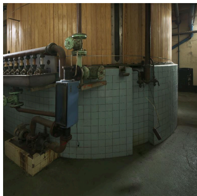
Cuve de filtration. Phot. Thierry Lefébure IVR32_20168000076NUC2A
