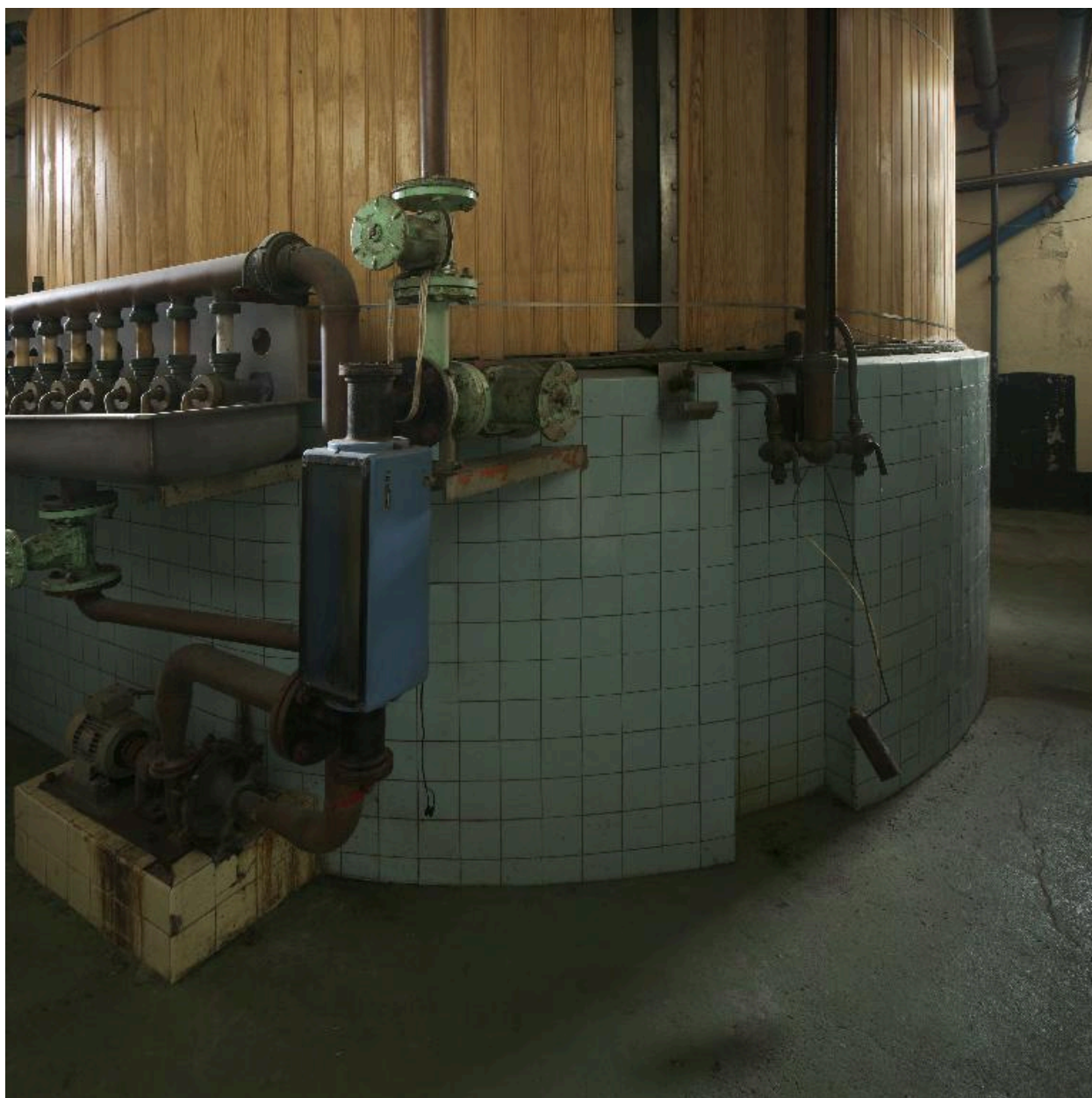
Cuve de filtration.
