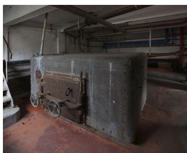
Cuve (?) au 2e niveau de la brasserie. IVR32_20168000079NUC2A
