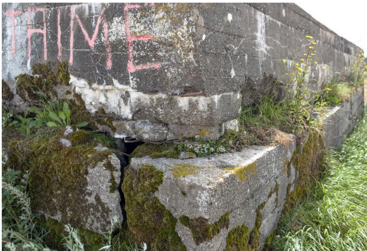
Angle nord-est. Effet du dynamitage de l'abris
