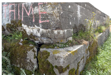
Angle nord-est. Effet du dynamitage de l'abris Phot. Jean-Marc Ramette IVR31_20145905142NUCA
