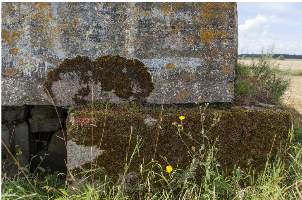
Angle nord-est. Effet du dynamitage de l'abris
