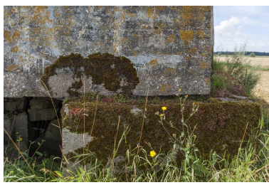
Angle nord-est. Effet du dynamitage de l'abris Phot. Jean-Marc Ramette IVR31_20145905139NUCA
