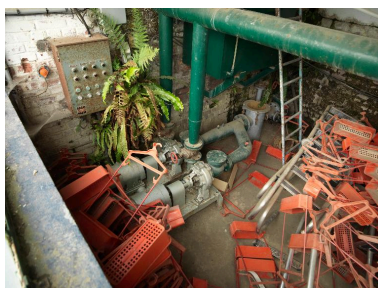
Ancien local technique sous les gradins de l'ancienne piscine : panneau de contrôle, pompes, vannes, tuyauterie et portes-habits. Phot. Marie-Laure Monnehay-Vulliet IVR32_20178000458NUC2A
