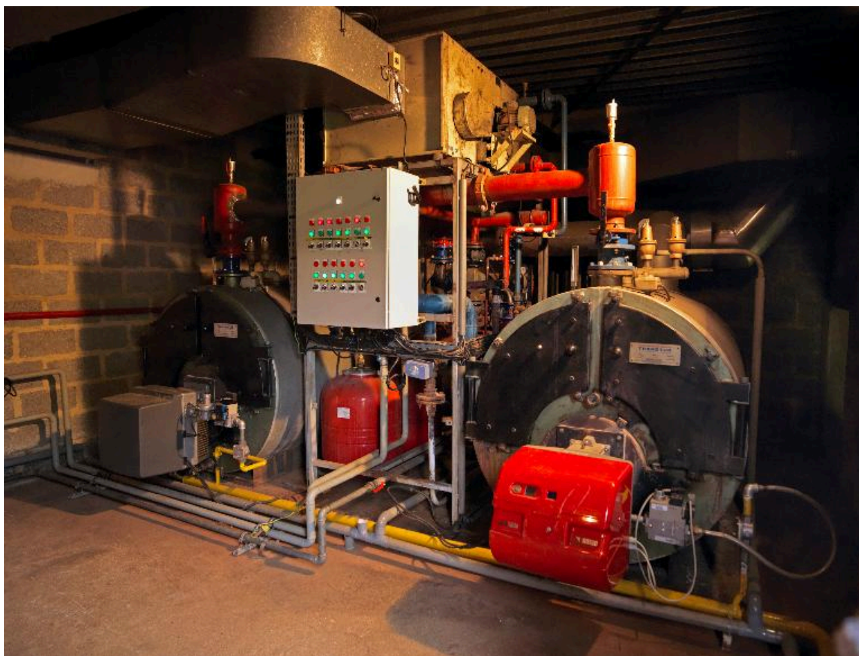
Local technique : chaudières.
