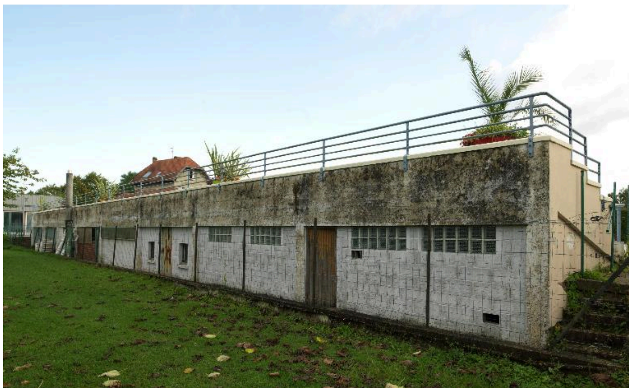
Gradins de l'ancienne piscine découverte, qui abritaient la machinerie et des vestiaires.
