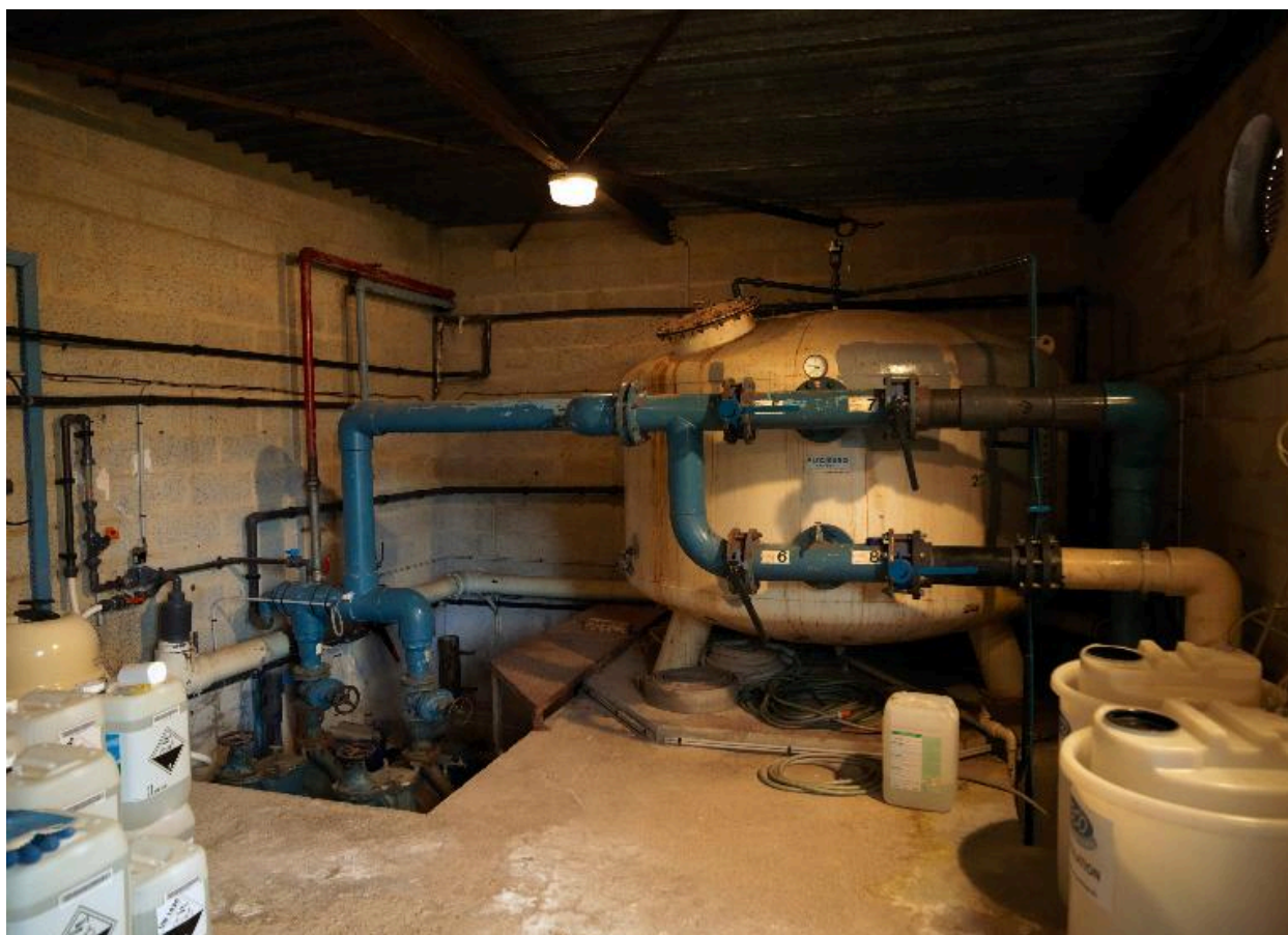
Local technique : filtre à sable "Piscinaro" (d'origine).
