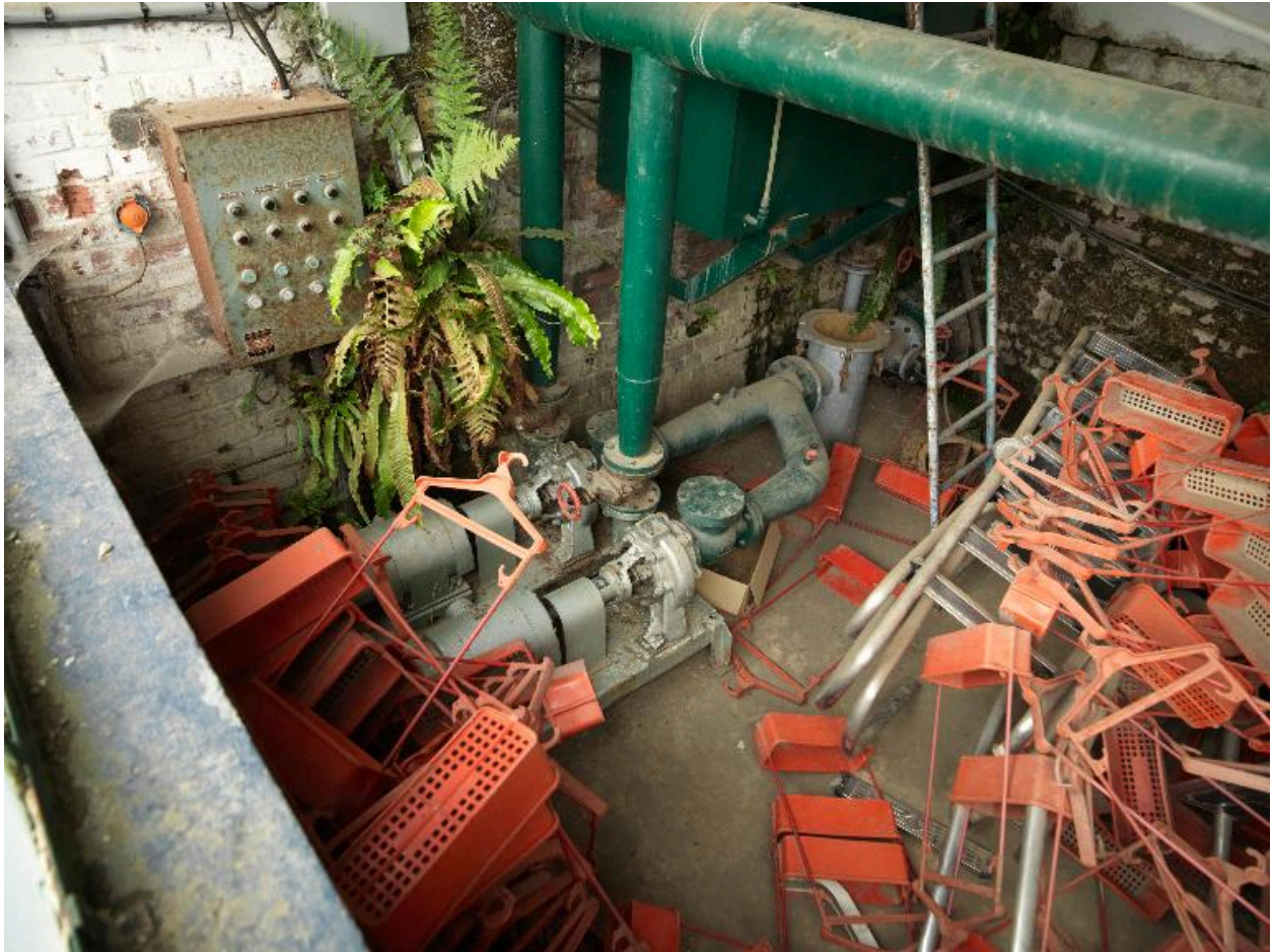
Ancien local technique sous les gradins de l'ancienne piscine : panneau de contrôle, pompes, vannes, tuyauterie et portes-habits.
