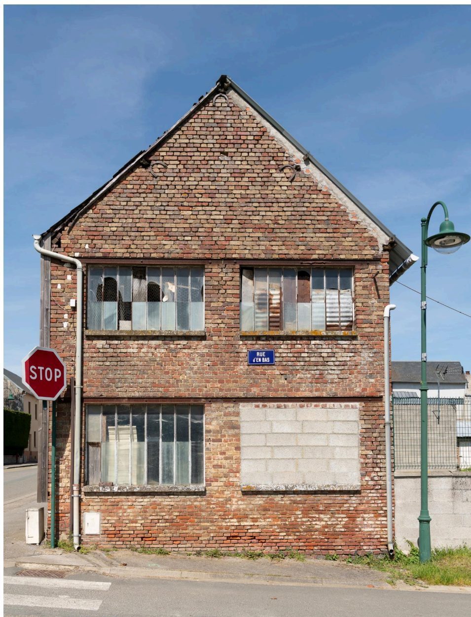
Mur-pignon de l'ancienne fabrique de boutons de nacre, vue prise depuis le sud.
