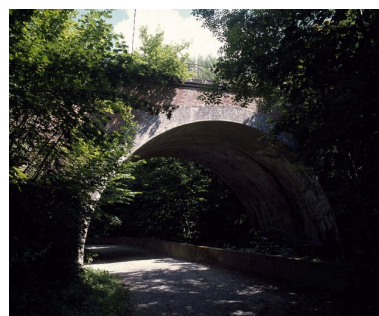
Canaples. Le pont ferroviaire de la ligne Amiens-Doullens traversant la Nièvre. Phot. Marie-Laure Monnehay-Vulliet IVR22_20098000236XA
