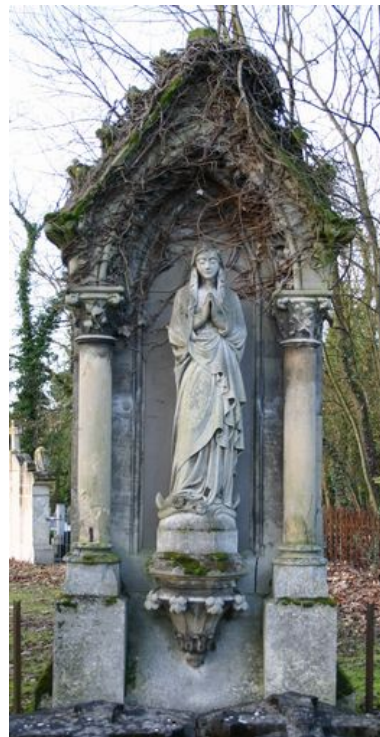
Stèle architecturée servant de niche à une statue de la Vierge, A. Sallé (entrepreneur), vers 1891. Phot. Caroline Vincent IVR22_20098000511NUCA
