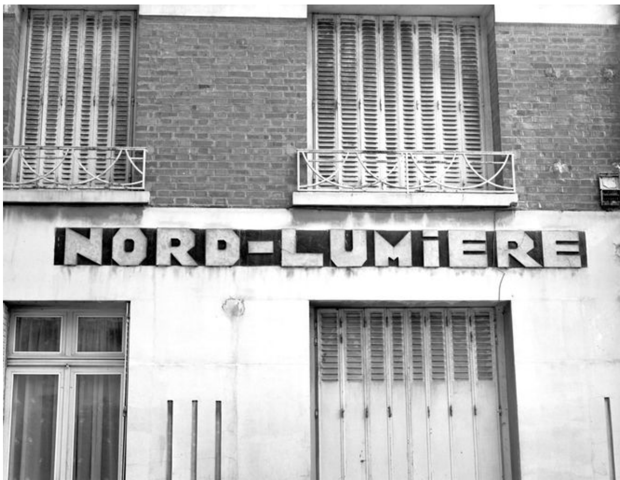
Détail du panneau de grès cérame indiquant la raison sociale du transformateur.
