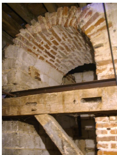
Baie sud de l'ancien clocher-mur. Phot. Frédéric Fournis IVR22_20108001956NUCA
