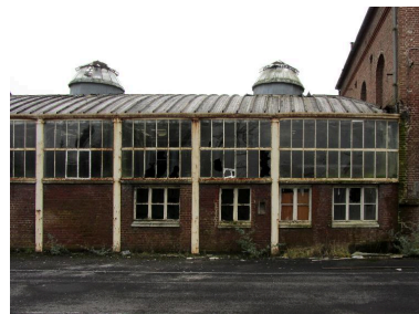
Vue partielle de la façade d'un des magasins à fils. Phot. Bertrand Fournier IVR22_20138016191NUC2A
