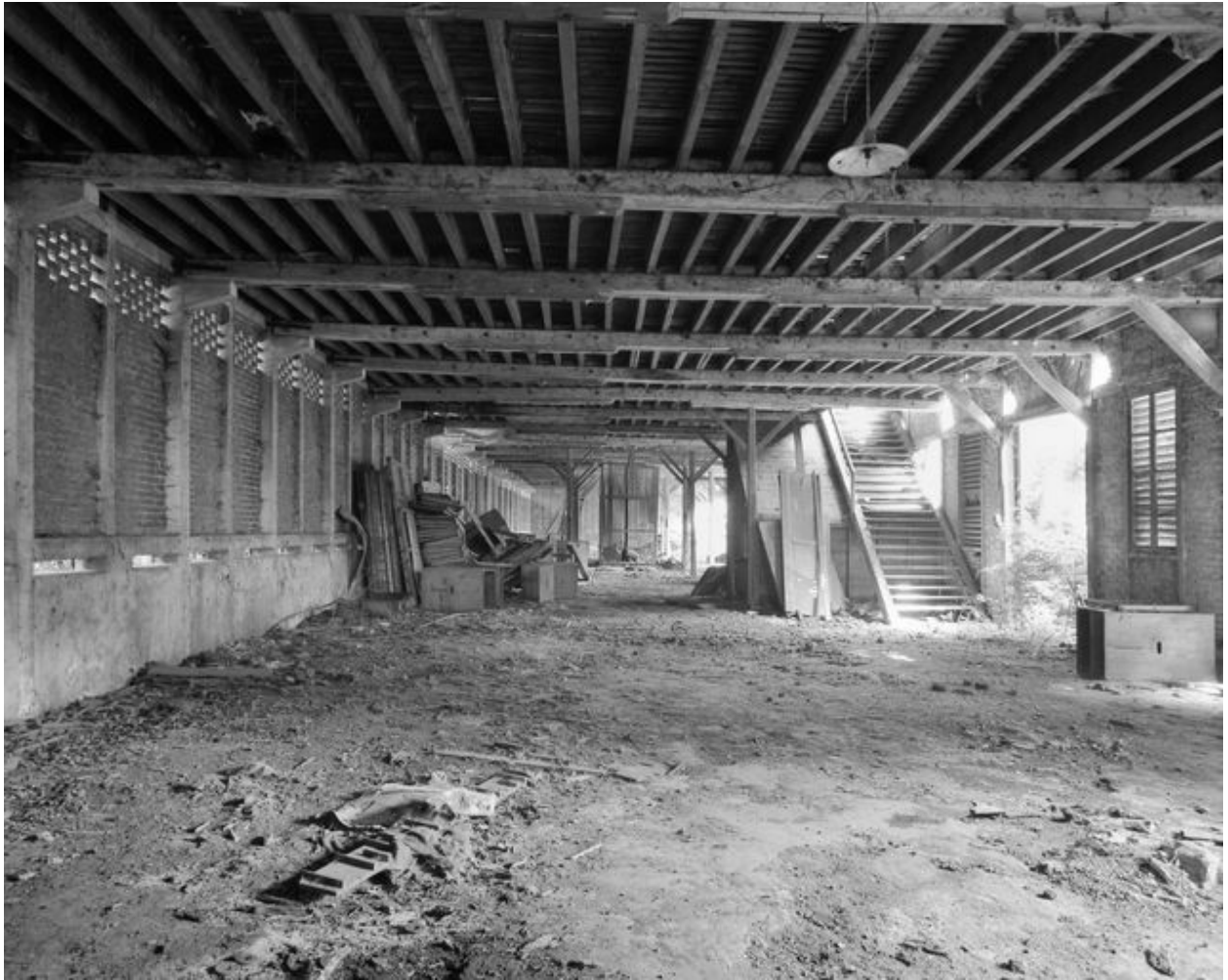
Séchoir à bois, en 1989 : vue intérieure.
