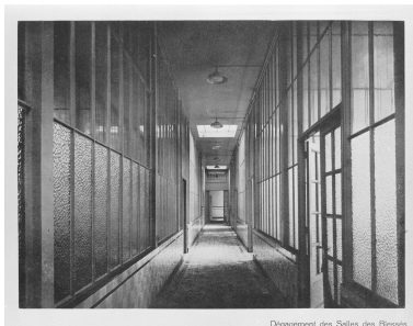
Premier étage : couloir des salles des blessés, ca1933. Extrait du Recueil d'architecture d'Adolphe Danis, 1927-1934 (AP Dieux). Repro. Olivier Marlard IVR31_19925901776XB
