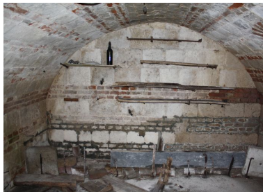
Vue intérieure de la cave voûtée en plein cintre. Phot. Bertrand Fournier IVR22_20098005118NUCA
