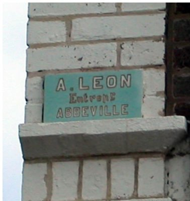
Détail du carreaux de céramique portant signature du maître d'oeuvre. Phot. Elisabeth Justome IVR22_20058003128NUCA
