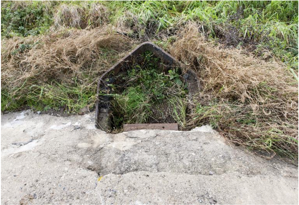
Depuis le couvrement, vue de l'observatoire cuirassé (endommagé)
