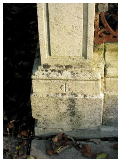
Détail du pilier gauche de la clôture. Phot. Laurent Nicolas IVR22_20048001307NUCA
