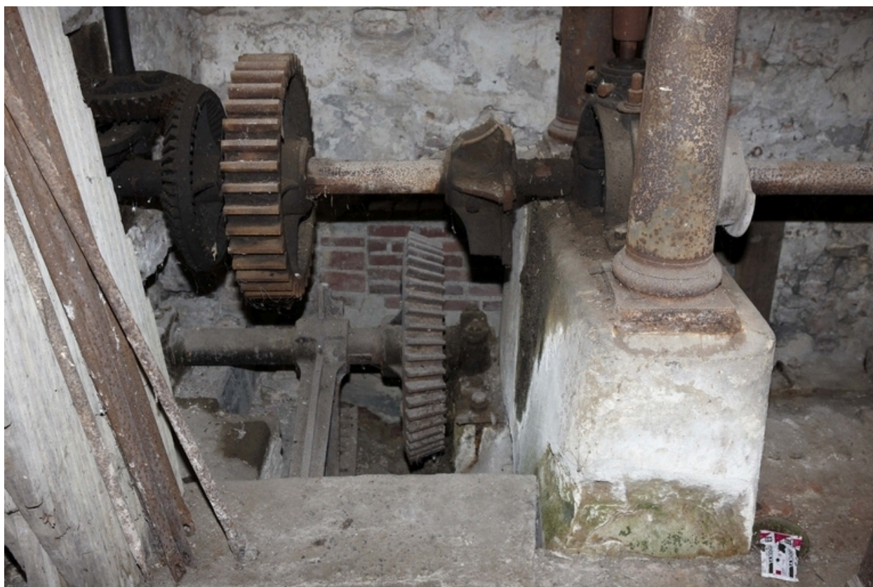
Détail de l'arbre moteur et des embrayages coniques (endommagés).
