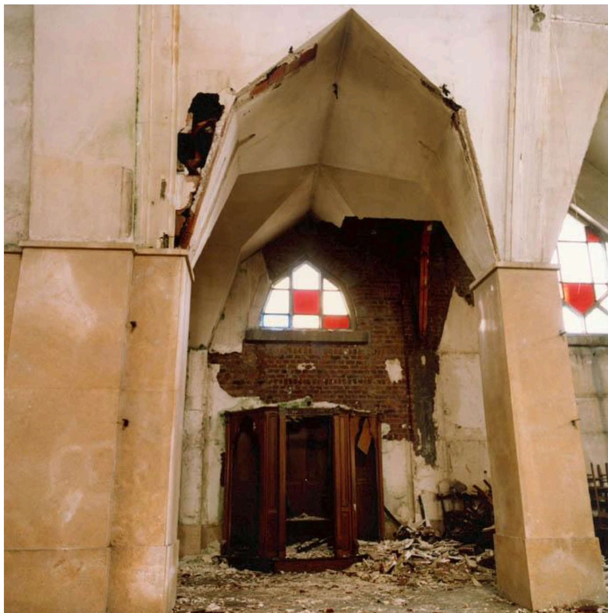
Vue intérieure, état de dégradation de la troisième travée du bas côté occidental, avant sa destruction. Photographie, photographe inconnu, circa 1985-1986 (AC Aulnoye-Aymeries).
