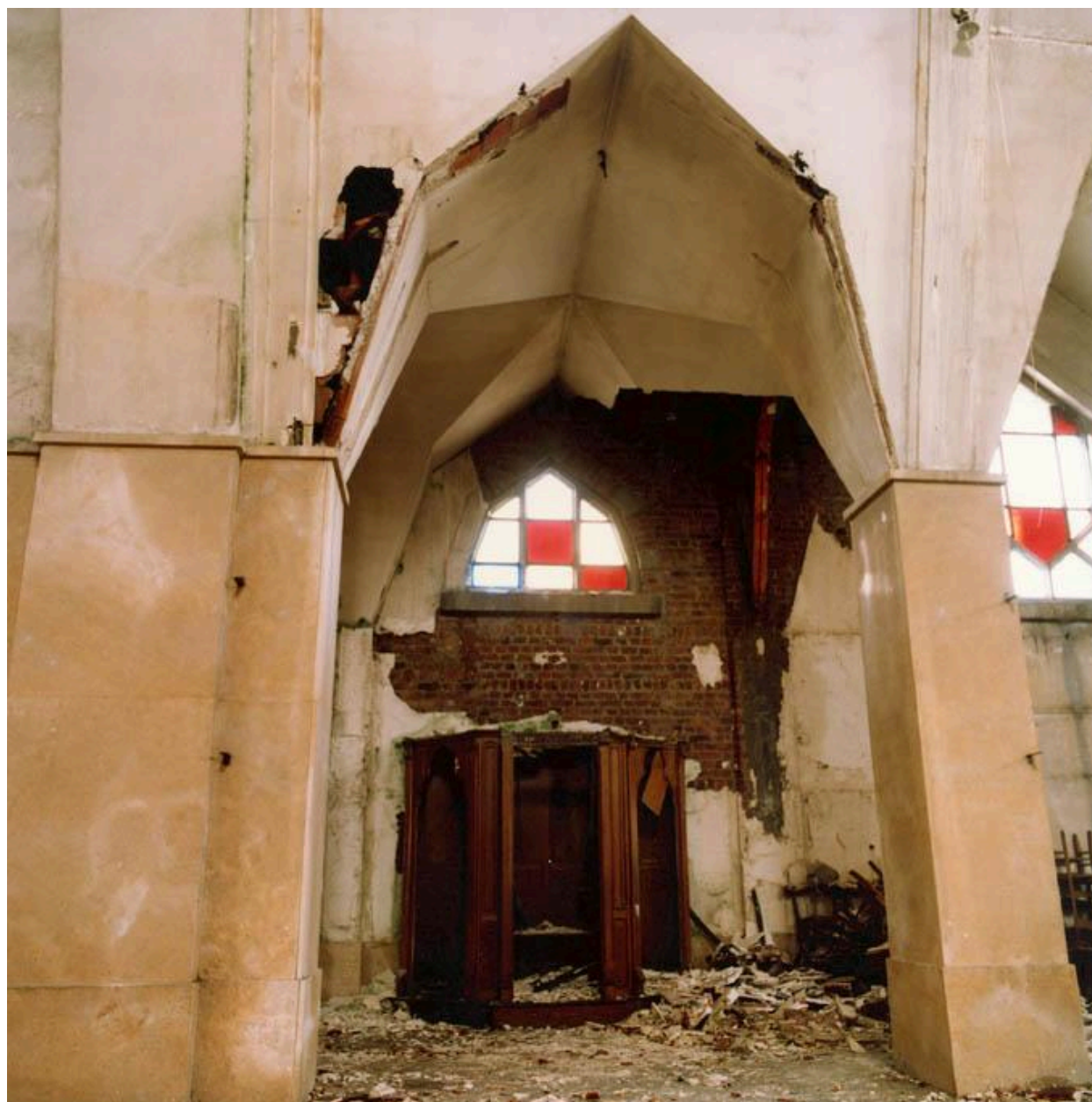
Vue intérieure, état de dégradation de la troisième travée du bas côté occidental, avant sa destruction. Photographie, photographe inconnu, circa 1985-1986 (AC Aulnoye-Aymeries).
