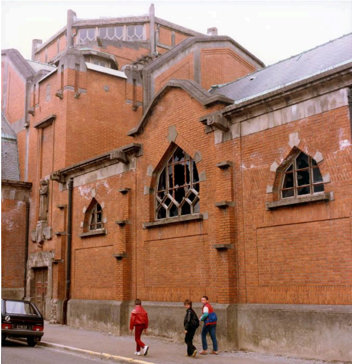
Vue partielle de l'élévation orientale et du transept, avant sa destruction. Photographie, photographe inconnu, circa 1985-1986 (AC Aulnoye-Aymeries).
