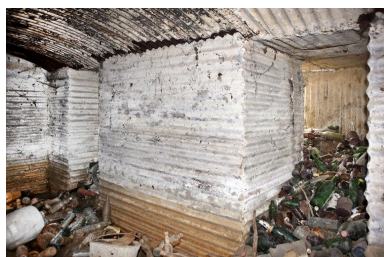
Vue intérieur : le couloir d'enroule autour du pilier de soutènement Phot. Jean-Marc Ramette IVR31_20146203027NUCA
