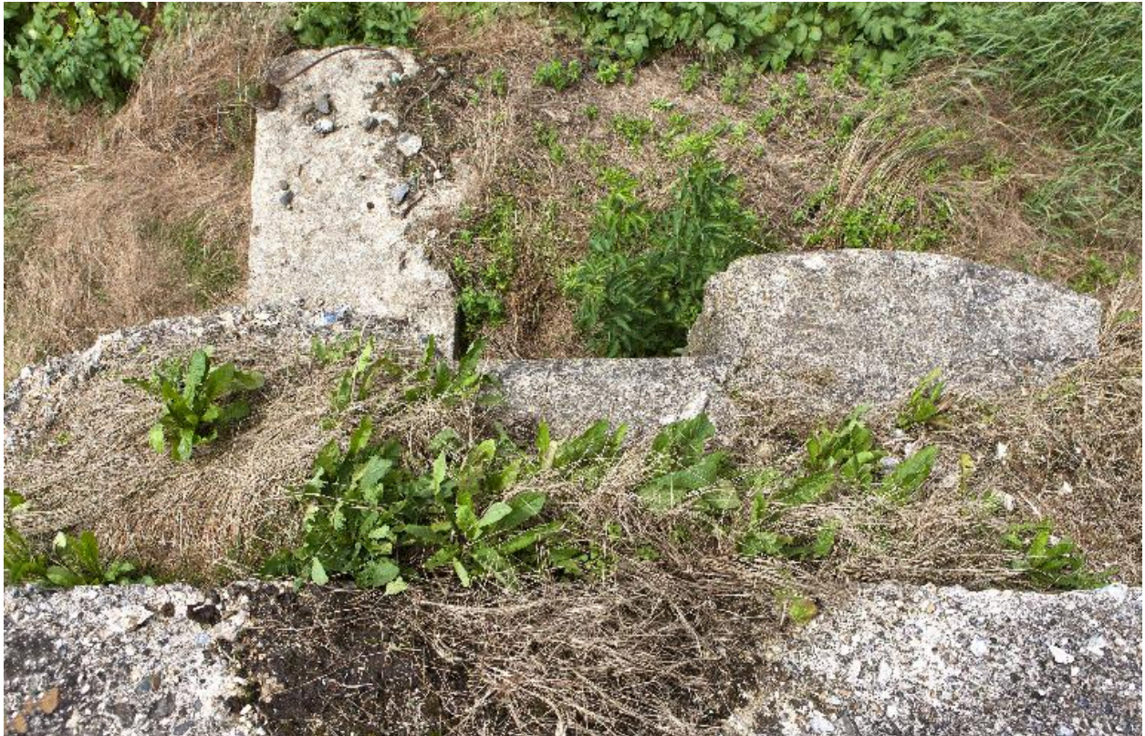
Vue de dessus du porche pare-souffle
