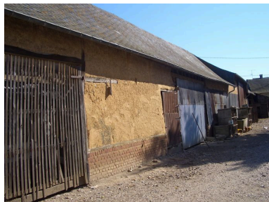
Vue de la partie sud de la grange. Phot. Inès Guérin IVR22_20068005271NUCA
