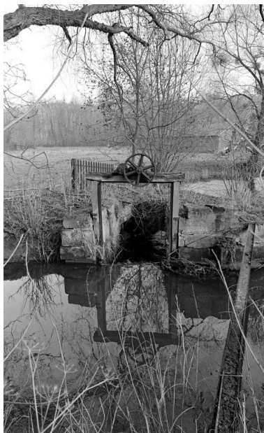
Vanne de décharge. Phot. Benoît Dufournier IVR22_19936000019Z
