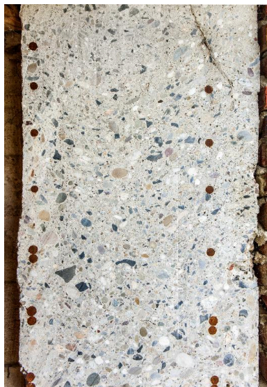
Partie tronçonnée du mur sud-est de la casemate laissant voir le ferrailage en coupe. Phot. Jean-Marc Ramette IVR31_20145904496NUCA
