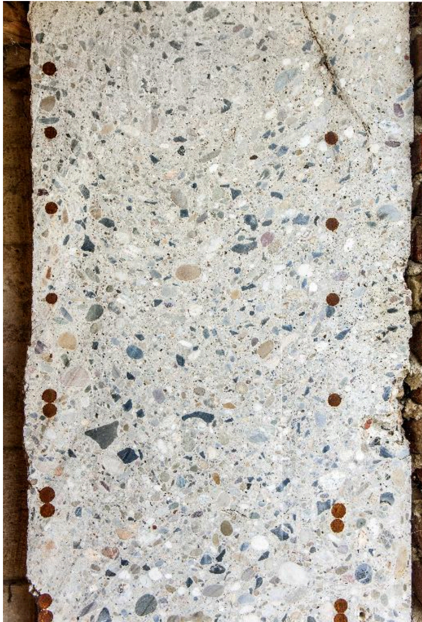
Partie tronçonnée du mur sud-est de la casemate laissant voir le ferrailage en coupe.
