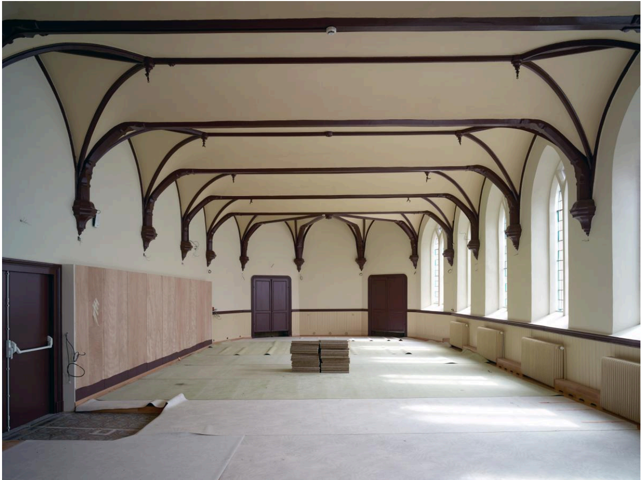
Salle du rez-de-chaussée de la chapelle, ancien réfectoire des élèves. Vue orientée ouest-est.
