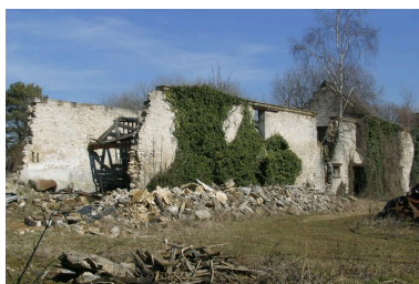
Etat actuel de la grange en ruines. Phot. Irwin Leullier IVR22_20050200715NUCA
