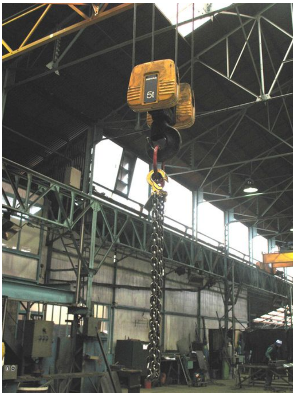
Grue de levage de 5 tonnes.
