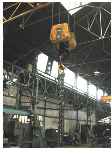
Grue de levage de 5 tonnes. Phot. Clarisse Lorieux IVR22_20076005254NUCA
