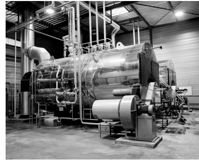
Vue intérieure de la chaufferie avec ses deux chaudières. Phot. Thierry Lefébure IVR22_19950202981X
