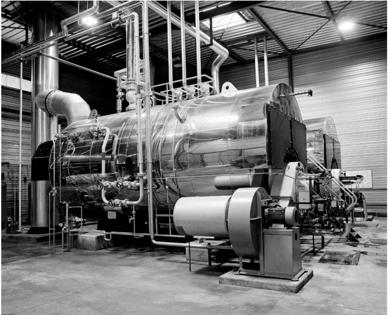
Vue intérieure de la chaufferie avec ses deux chaudières.
