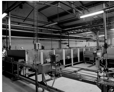
Machine servant à pasteuriser les pots. Phot. Thierry Lefébure IVR22_19950202969X
