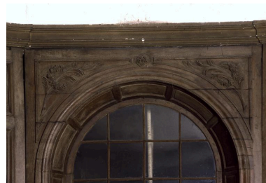
Détail du décor sculpté des lambris du mur oriental. Phot. Irwin Leullier IVR22_20010202331ZA
