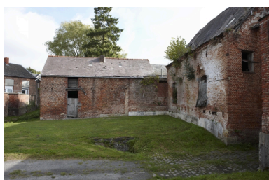
Détail de l'élévation sur rue : l'ancienne salle des cuves et l'étable. Phot. Pierre Thibaut IVR31_20095903256NUCA
