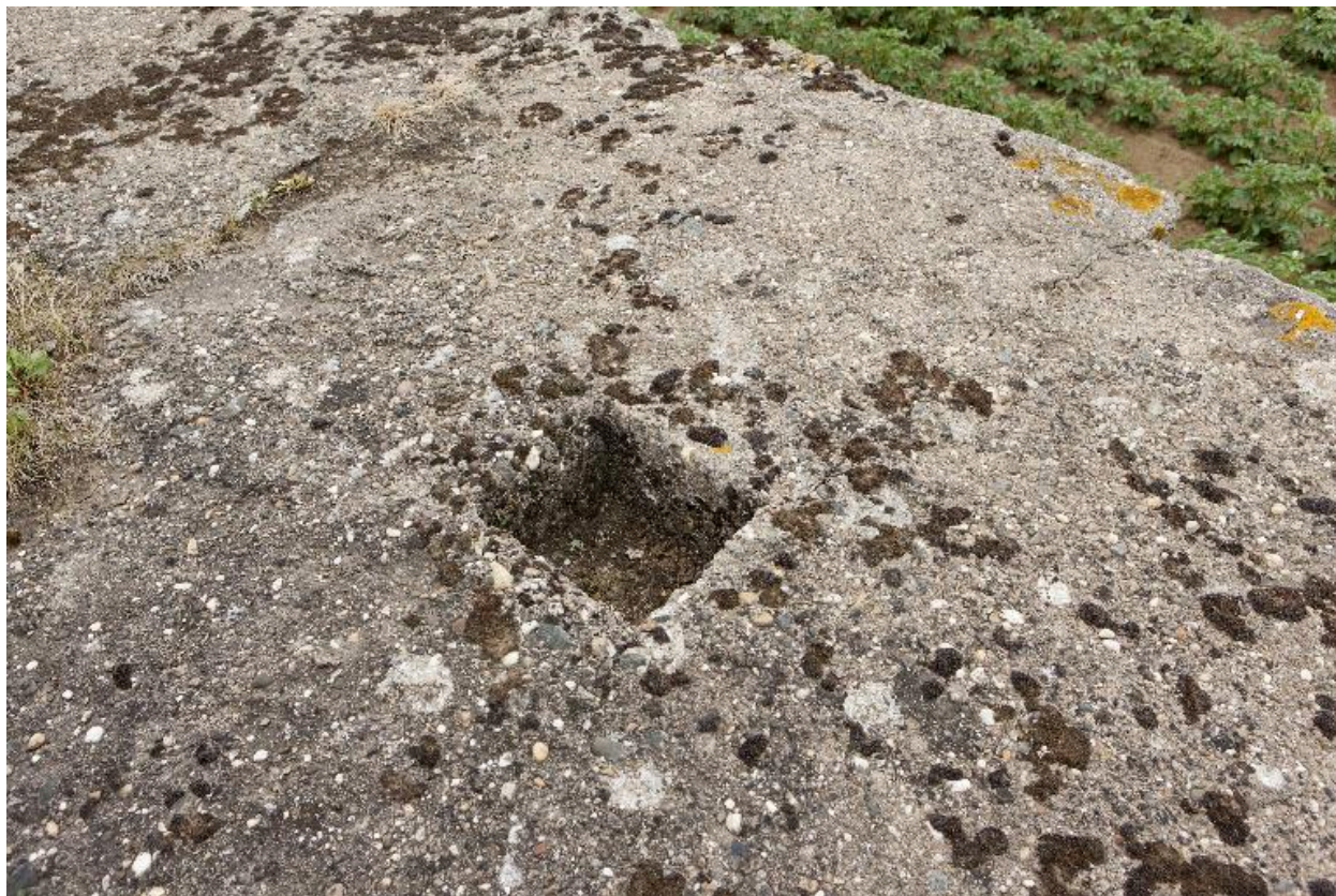
Couvrement, détail d'un conduit de cheminée obstrué
