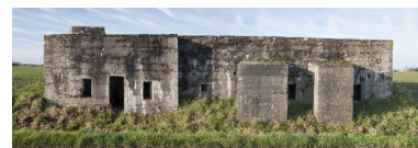
Elévation est. A gauche, deux entrées protégées de porches pare-souffle. Sur le toit, les vestiges, peut-être, du troisième porche Phot. Jean-Marc Ramette IVR31_20145905273NUCA
