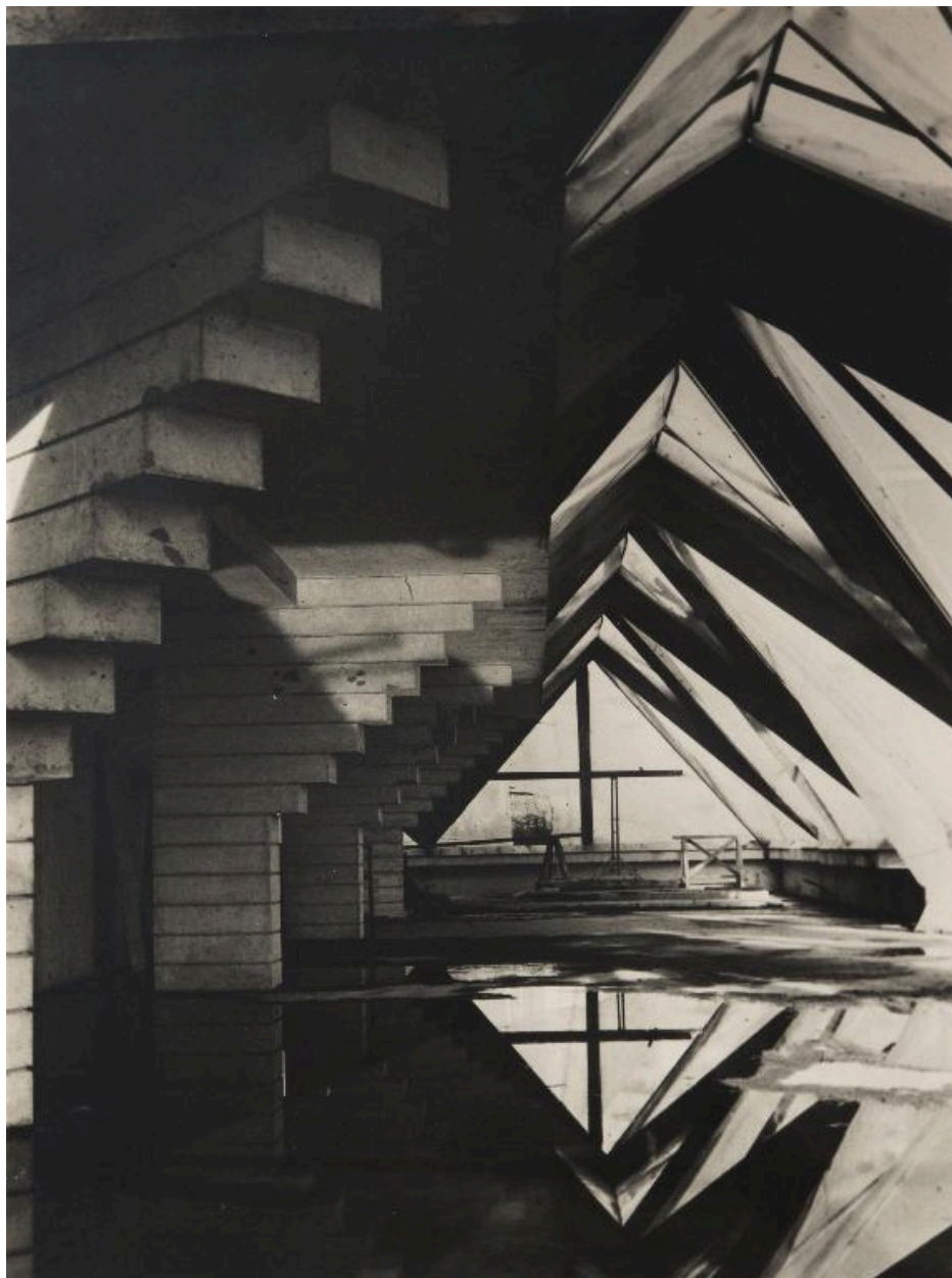
L'édifice en cours de construction. Vue du niveau inférieur. Photographie, vers 1970. AP Jean XXIII, Saint-Quentin.
