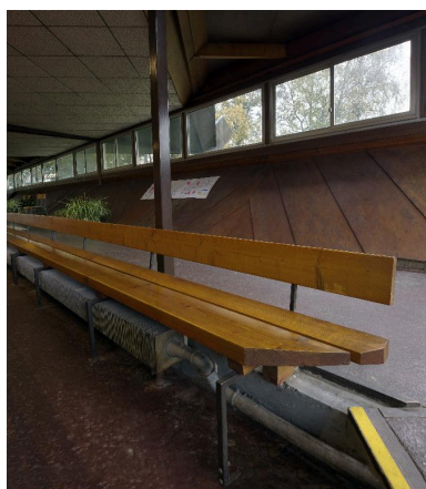
Vue de détail du système de chauffage. Phot. Thierry Lefébure IVR32_20170200391NUC2A
