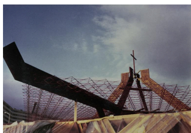
L'édifice en cours de construction. Vue de la charpente et du clocher horizontal. Photographie, vers 1970. AP Jean XXIII, Saint-Quentin. Phot. Thierry Lefébure IVR32_20170200404NUC2A
