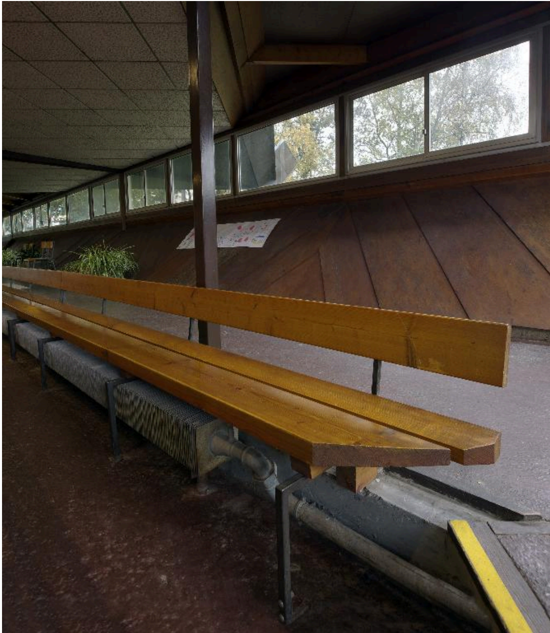
Vue de détail du système de chauffage.
