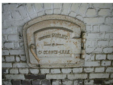
Détail de plaque de chaudière Sterling. Phot. Bertrand Fournier IVR22_20046002842NUCA
