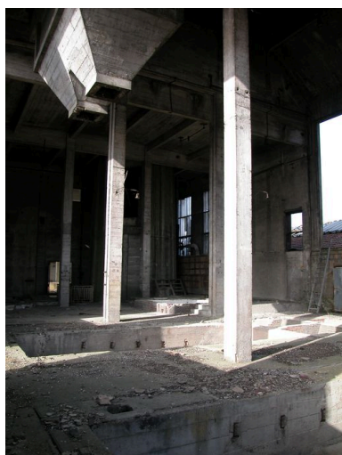
Intérieur du premier étage de la chaufferie. Phot. Bertrand Fournier IVR22_20046002843NUCA
