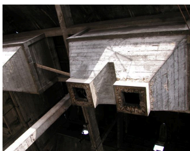
Intérieur de la chaufferie, détail des déversoirs en béton armé. Phot. Bertrand Fournier IVR22_20046002844NUCA
