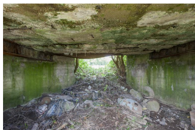
Depuis la chambre de tir, vers le nord-ouest (vers le front) Phot. Pierre Thibaut IVR31_20155901306NUCA
