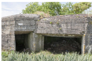
Élévation antérieure. Entrée de la chambre de tir, à droite et de la soute à munitions, à gauche Phot. Pierre Thibaut IVR31_20155901314NUCA
