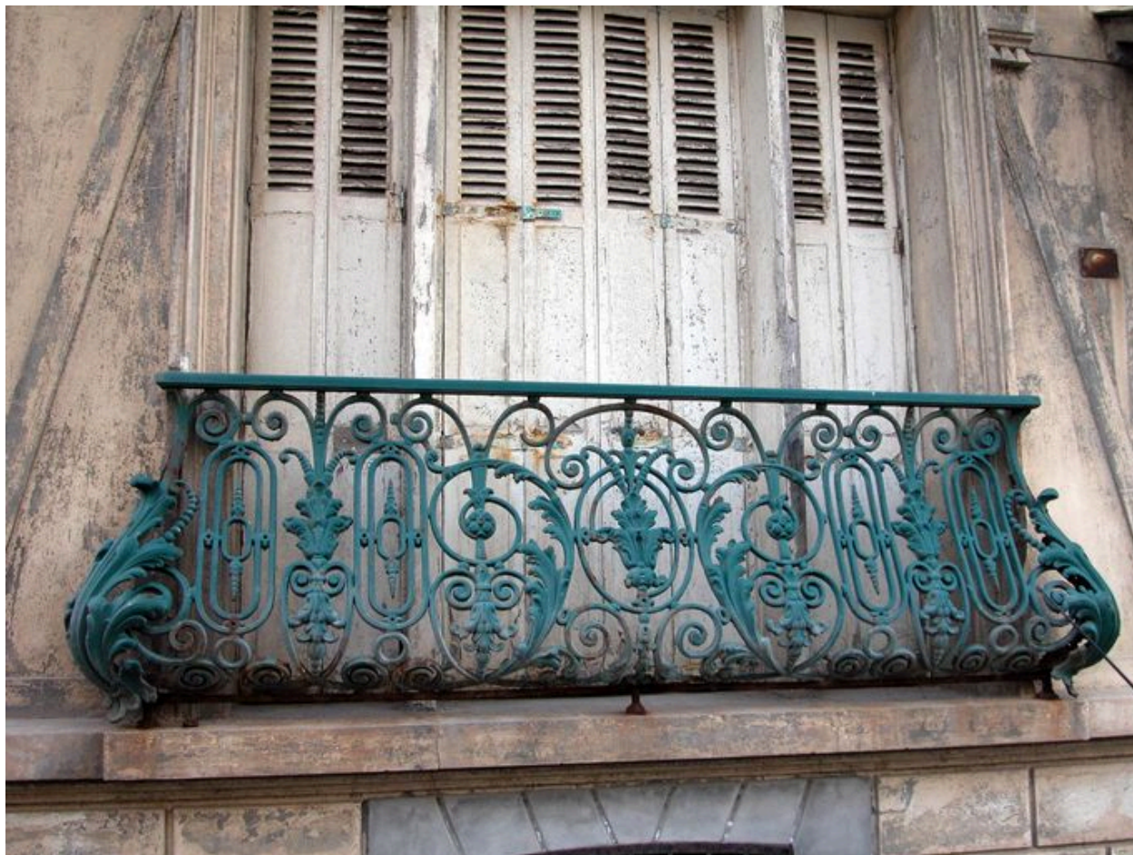
Détail du décor de fonte du garde-corps de balconnet de l'habitation sans appellation (partie droite de la maison).
