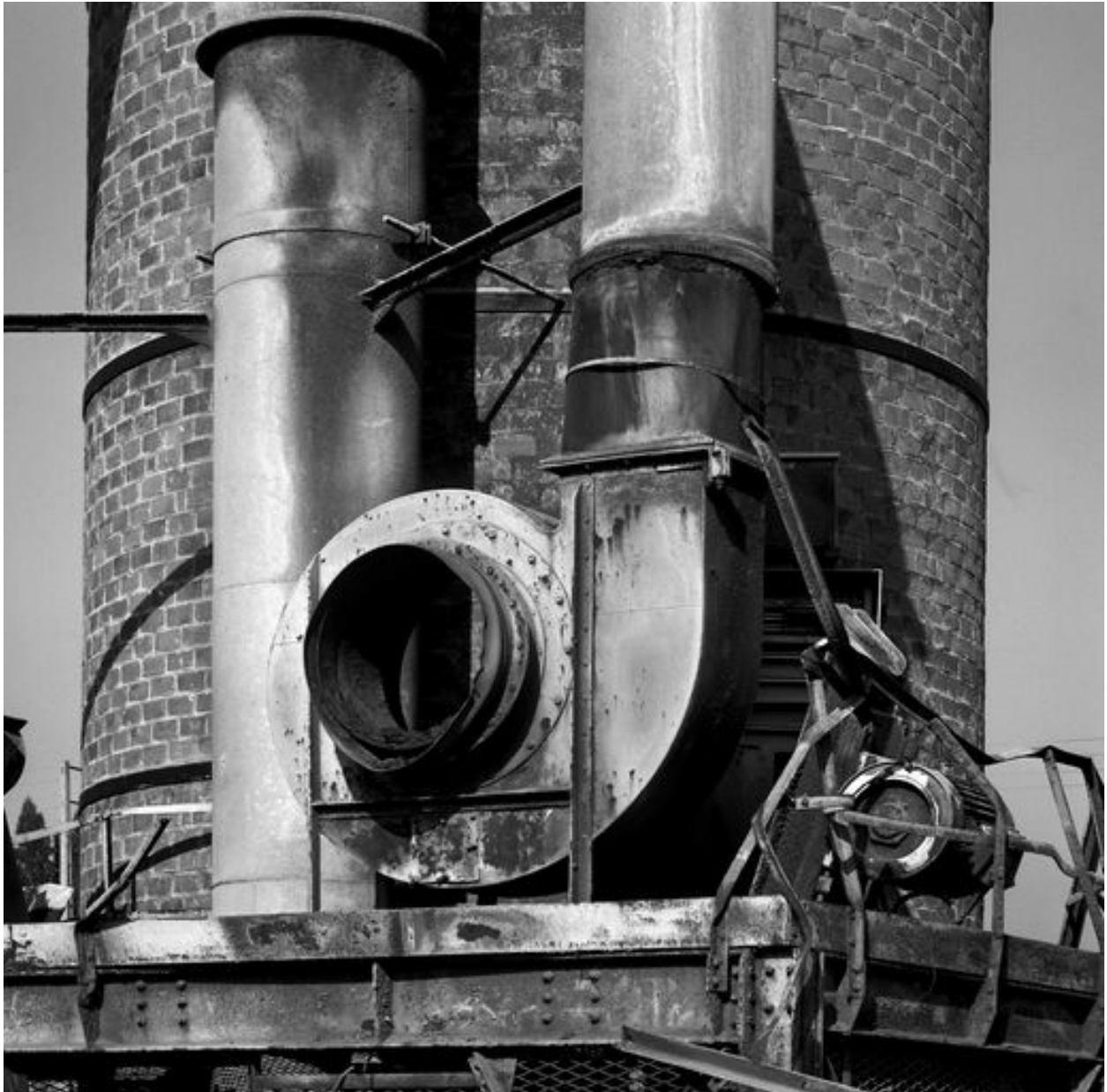
Ventilation de la cheminée.
