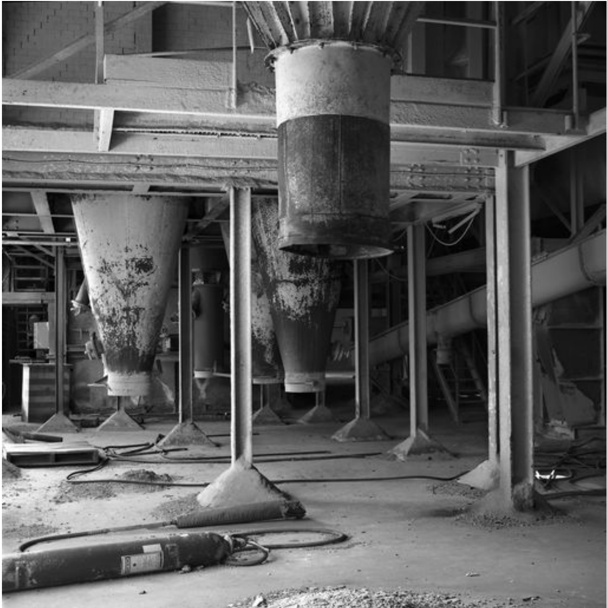
Trémies dans le bâtiment des fours.
