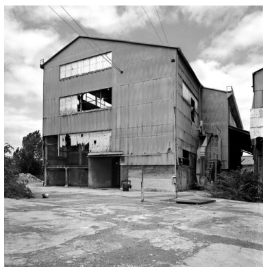
Bâtiment de stockage en cours de démolition, en 1999. Phot. Thierry Lefébure IVR22_19996000470X
