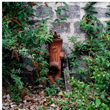
Borne incendie. Phot. Thierry Lefébure IVR22_20076000089XA
