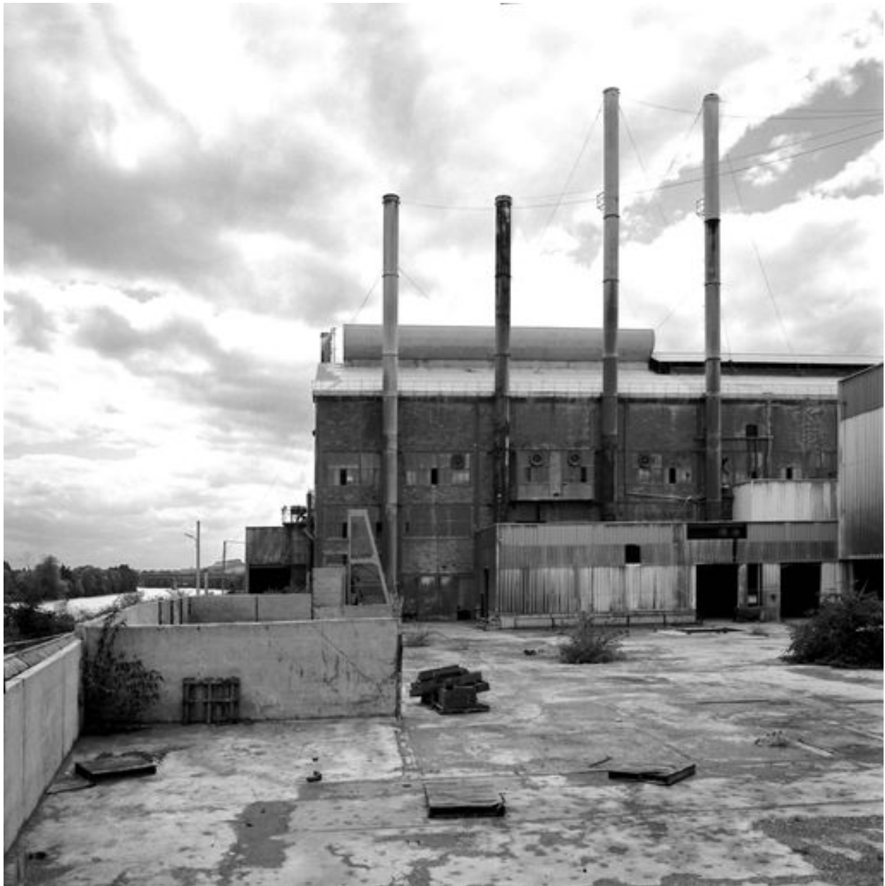
Façade nord-est du bâtiment abritant les fours, en cours de démolition, en 1999.
