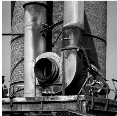
Ventilation de la cheminée. Phot. Thierry Lefébure IVR22_19996000844X
