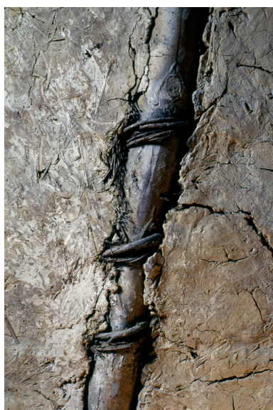
Barzy-en-Thiérache, ferme (repérée), 30 rue Neuve : détail d'une cloison en torchis dans le comble du logis. Phot. Christiane Riboulleau IVR22_19930201049ZA
