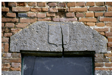
Barzy-en-Thiérache, ferme (repérée), 38 Grande-Rue : linteau de la porte du logis portant la date 1686. Phot. Christiane Riboulleau IVR22_19930201057ZA
