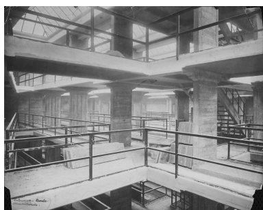
Intérieur du bâtiment du dépôt en chantier, vue prise depuis le vaisseau 4. Au sol, les rayonnages en béton attendent d'être montés sur les structures porteuses. Photographie (IFA ; 076 Ifa 108/10 : 2-3-047).
