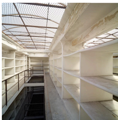
Bâtiment du dépôt, troisième étage : vue du vaisseau 2 vers l'est. Phot. Pierre Thibaut IVR31_20155902125NUCA
