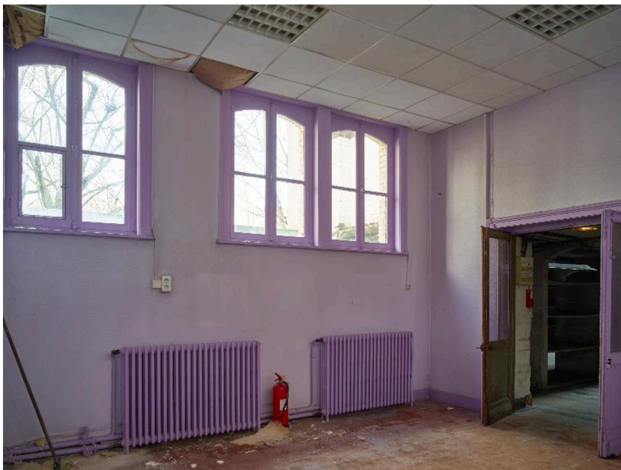
Bâtiment administratif, rez-de-chaussée : vue générale de la salle de triage. À droite, l'entrée du dépôt.
