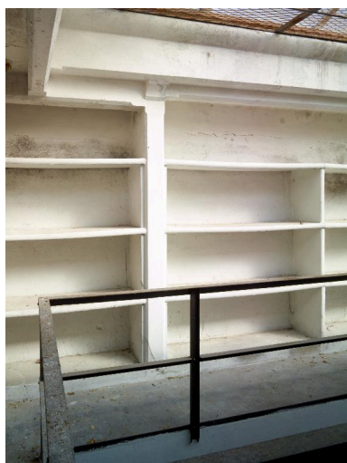
Bâtiment du dépôt, troisième étage : vue des rayonnages du vaisseau 4. Phot. Pierre Thibaut IVR31_20155902112NUCA
