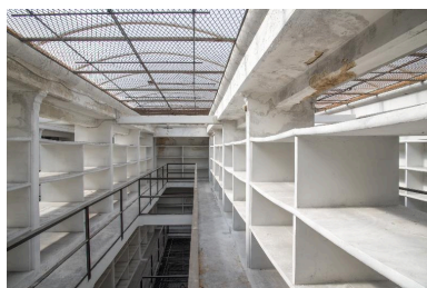
Bâtiment du dépôt, troisième étage : vue du vaisseau 2 vers l'ouest. Phot. Pierre Thibaut IVR31_20155901780NUCA
