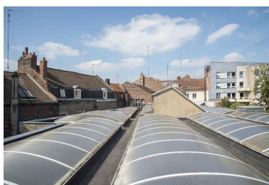
Vue générale du toit du dépôt vers le bâtiment administratif. Le bâtiment du dépôt se déploie en coeur d'îlot, sur l'arrière des propriétés bordant la rue Jacquemars-Giélée. Phot. Pierre Thibaut IVR31_20155901774NUCA
