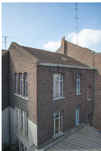
Vue générale de l'arrière du bâtiment administratif, côté nord, depuis le toit du bâtiment du dépôt. Phot. Pierre Thibaut IVR31_20155901776NUCA
