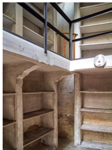
Bâtiment du dépôt, rez-de-chaussée : vue du système d'aération dans l'angle nord-ouest du vaisseau 1. Phot. Pierre Thibaut IVR31_20155902115NUCA
