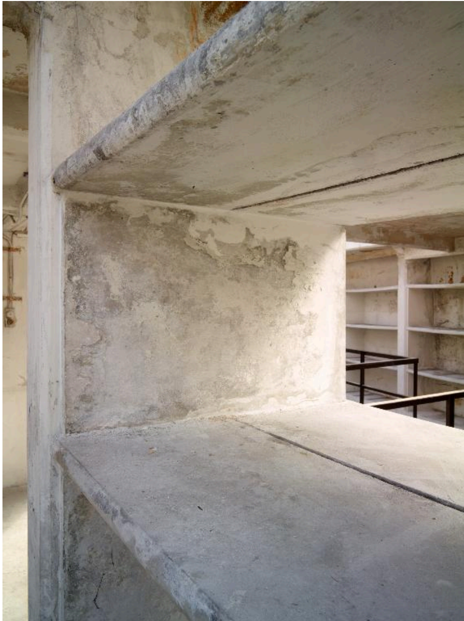
Bâtiment du dépôt, troisième étage : détail d'un rayonnage en béton armé. Chaque plateforme horizontale repose sur deux supports verticaux, eux-mêmes posés le long des piliers de béton.
