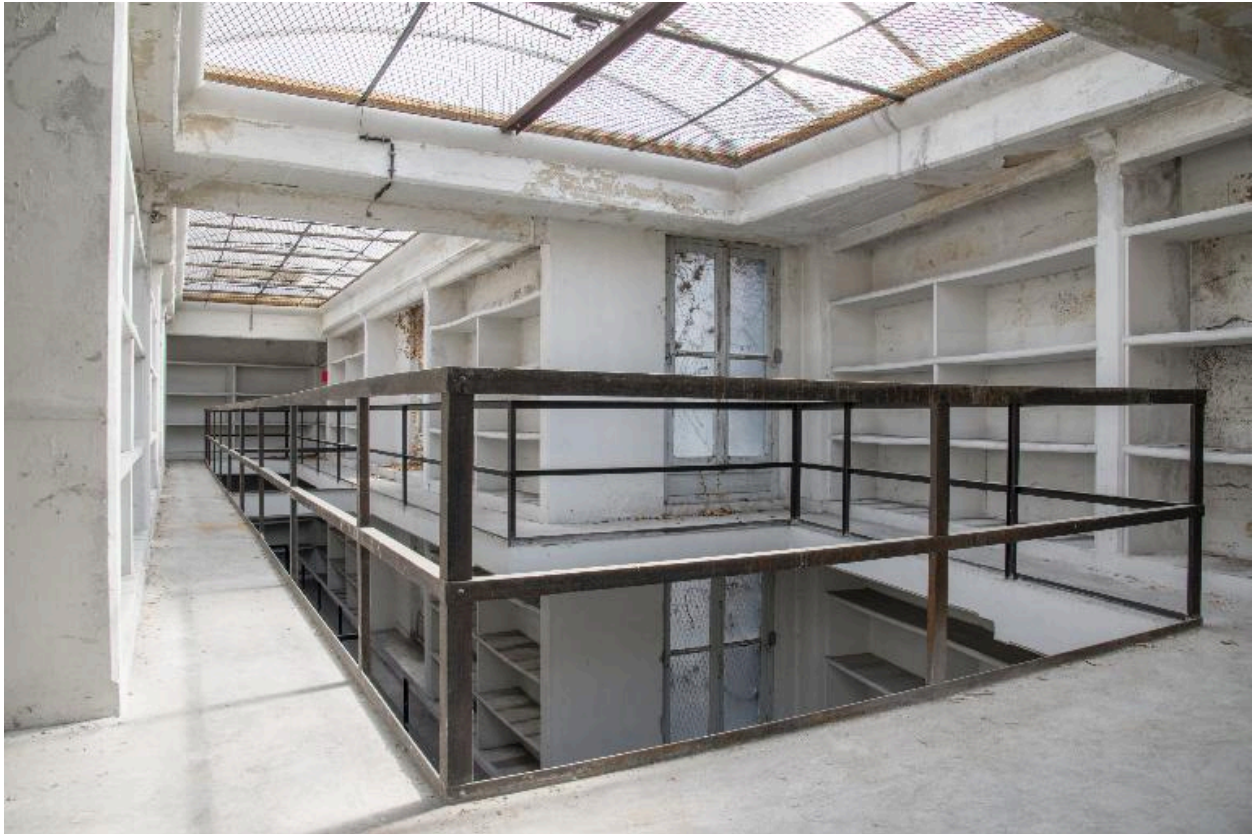
Bâtiment du dépôt, troisième étage : vue du vaisseau 4 vers l'est depuis le palier central.
