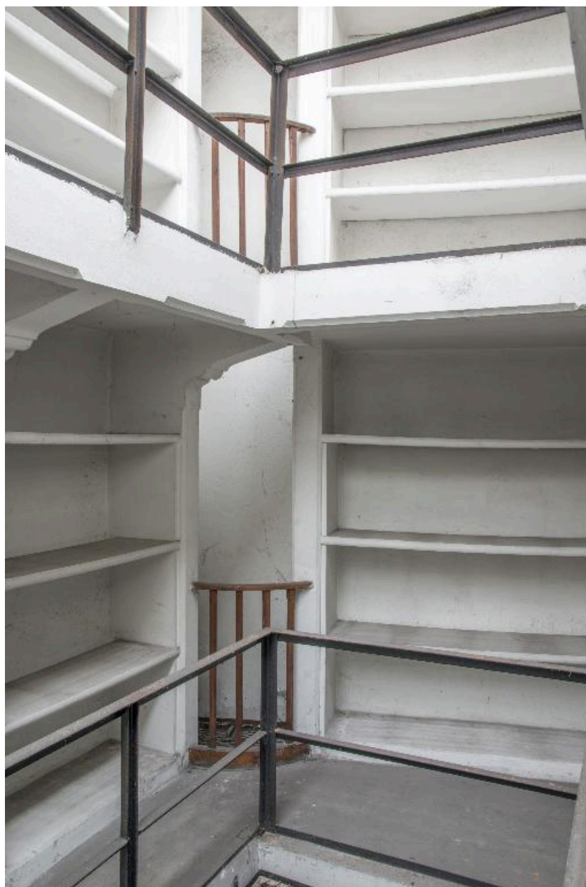
Bâtiment du dépôt, deuxième étage : vue du système d'aération du vaisseau 2, au nord-est.
