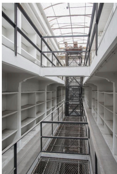
Bâtiment du dépôt, deuxième étage : vue du vaisseau 1 vers l'est. Phot. Pierre Thibaut IVR31_20155901843NUCA
