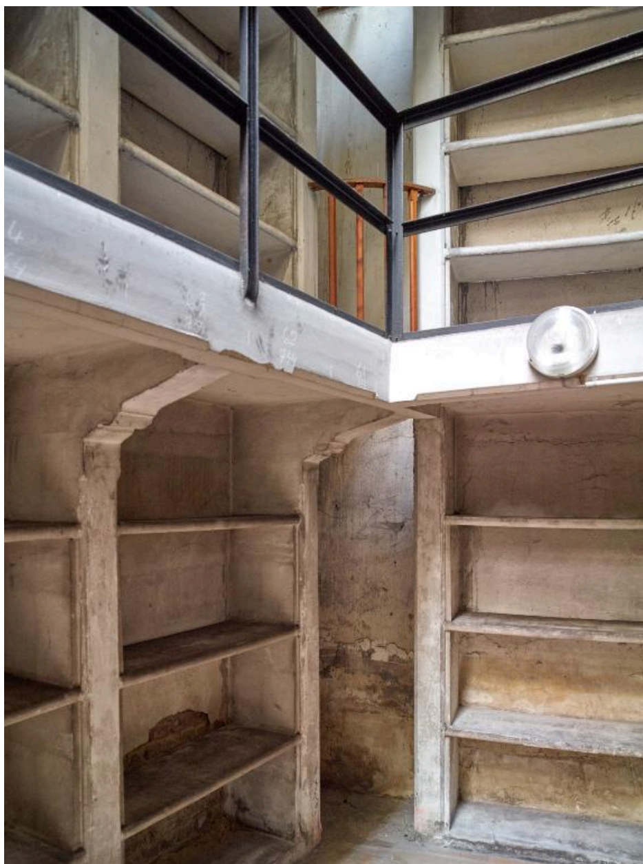
Bâtiment du dépôt, rez-de-chaussée : vue du système d'aération dans l'angle nord-ouest du vaisseau 1.
