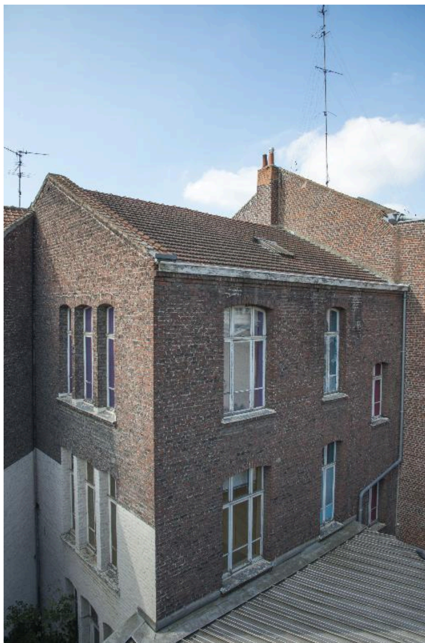
Vue générale de l'arrière du bâtiment administratif, côté nord, depuis le toit du bâtiment du dépôt.
