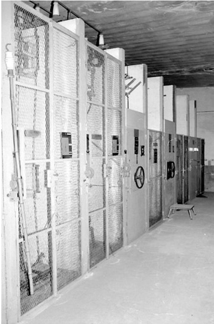
Transformateur : vue intérieure.
