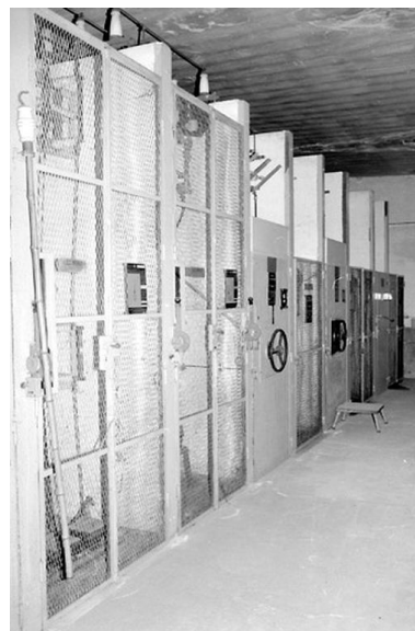
Transformateur : vue intérieure. Phot. Benoît Dufournier IVR22_19878000467Z
