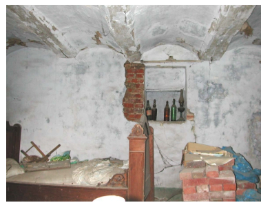
Logis de ferme, rue Morimetz, vue générale intérieure. Phot. Sophie Luchier IVR31_20045905500NUCA
