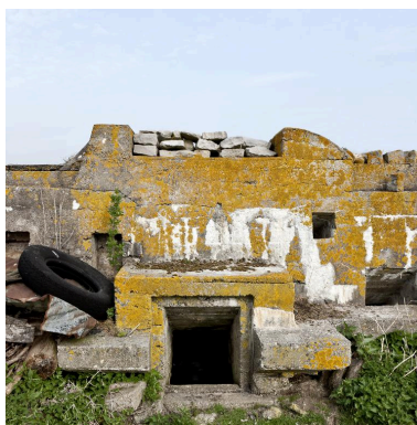
Elévation sud : Resserre à mitrailleuse sous la banquette de tir Phot. Jean-Marc Ramette IVR31_20145904766NUCA
