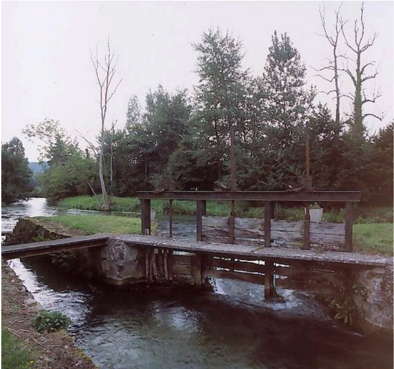
Le vannage de décharge.
