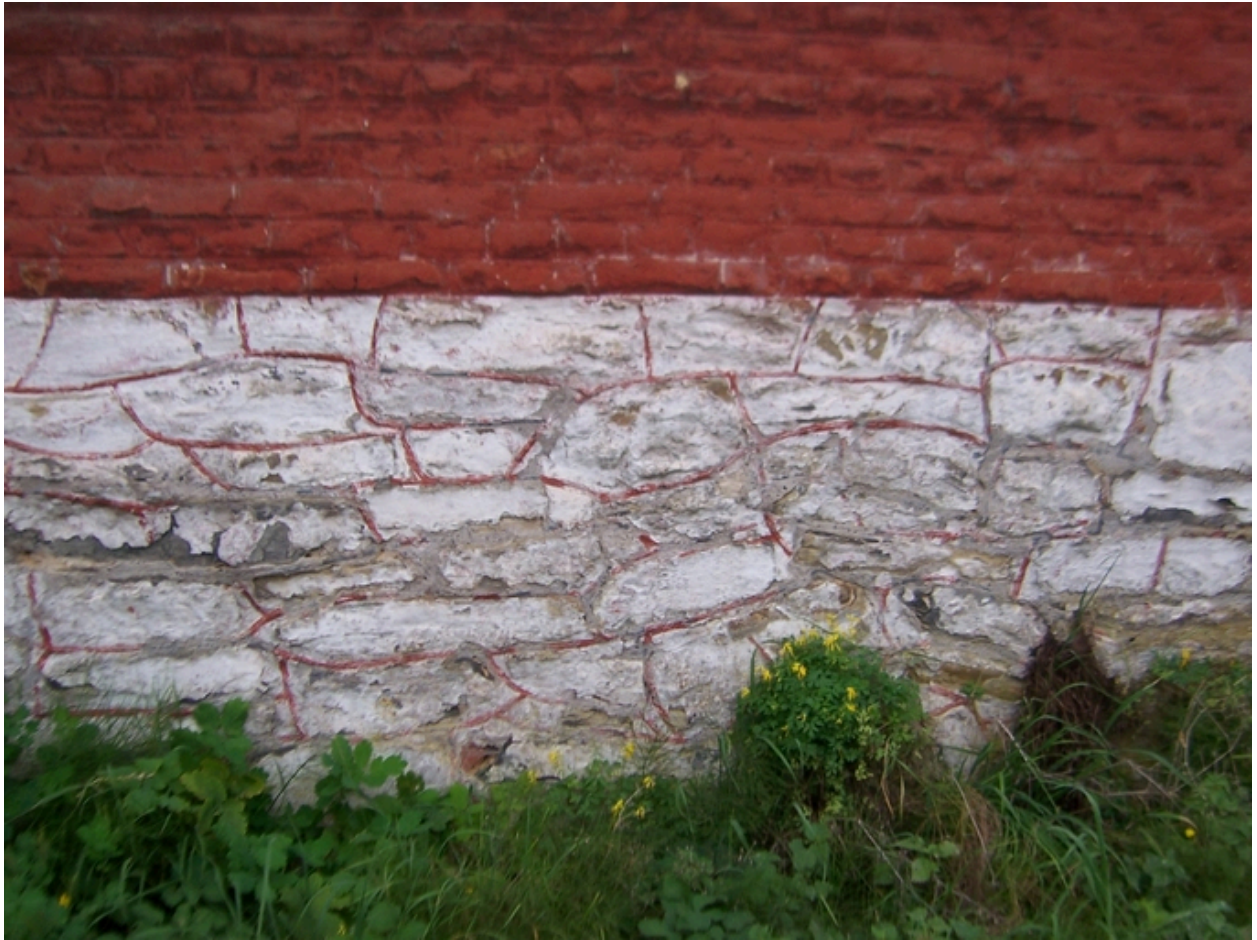
Détail du mur pignon sur rue : le soubassement en moellon de calcaire carbonifère (badigeonné de chaux).
