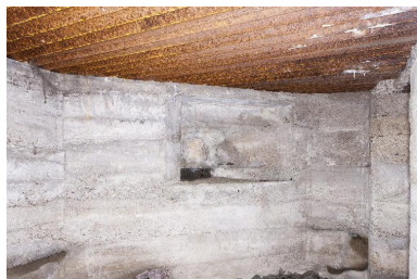
Casemate nord. Seconde salle. Ouverture de tir nord, condamnée Phot. Pierre Thibaut IVR31_20155902010NUCA
