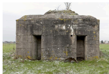
Casemate nord. Vue perpendiculaire à la face ouest. Les deux entrées. Phot. Jean-Marc Ramette IVR31_20145904258NUCA
