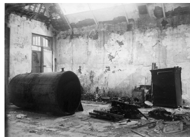
Vue intérieure du petit atelier acquis en 1912, photographié en 1918-1919 (AD Aisne). Phot. Pillet Frédéric IVR22_20060205612NUCAB
