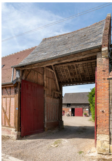
Entrée charretière sur rue, n°10 rue Tassart, vue depuis l'est. Phot. Marc Kérignard IVR32_20226000377NUCA
